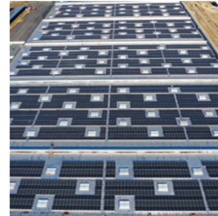
INTÉGRATION D'ÉNERGIES VERTES
